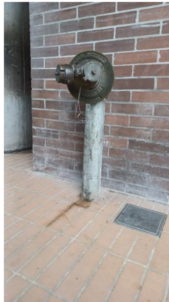
foto 5. Hidrantes (externo), (ubicadas en el edificio en el primer piso).
