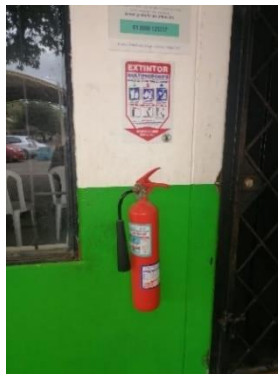
foto 2. Extintor CO2 (ubicados sala de sistemas, coordinación y edificio).
