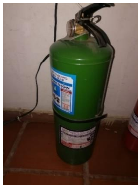
foto 3. Extintor de agua (ubicado en coordinación).
