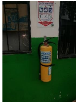
foto 1. Extintor multipropósito (ubicados en varios sitios dentro de la institución).
