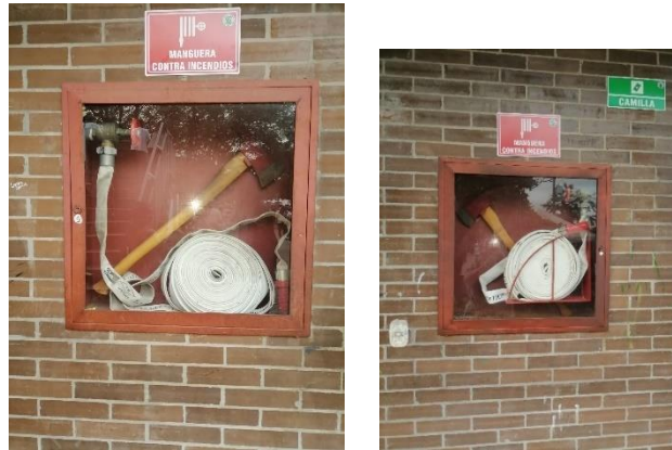
foto 4. Mangueras contra incendio (ubicadas en el edificio en el primer y segundo piso).
